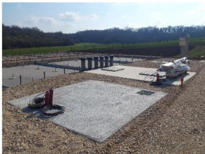
JUM – Plateforme 1 er étage (dalle chlorure ferrique)
